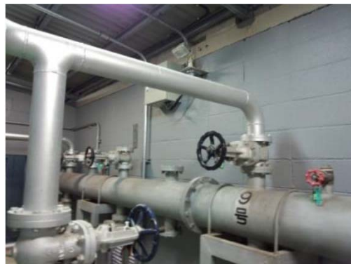
東電新島發電變電所
